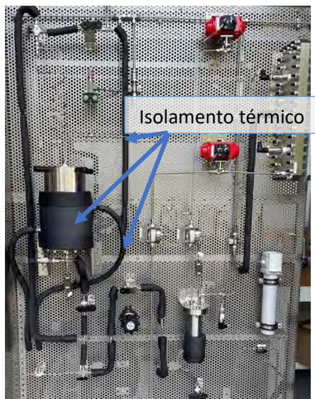
Figura 3 – Vista frontal da instalação laboratorial de extração e refinação após isolamento térmico das tubagens, permutadores de calor e vaso de CO 2 (E-4).
